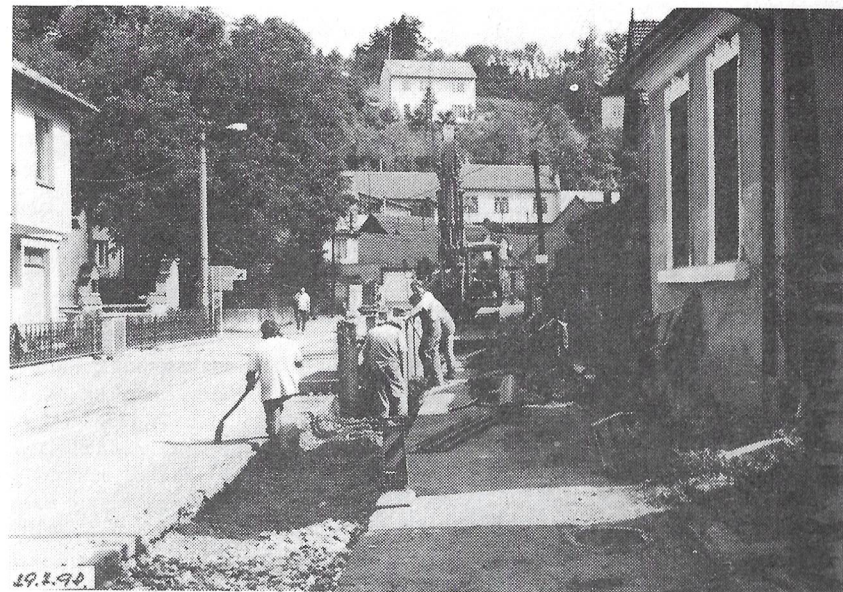
Ulice Havlíčkova - zasypávání položeného potrubí a budování výkopu pro položení kanalizačních skruží. Foto B. Zlámal
